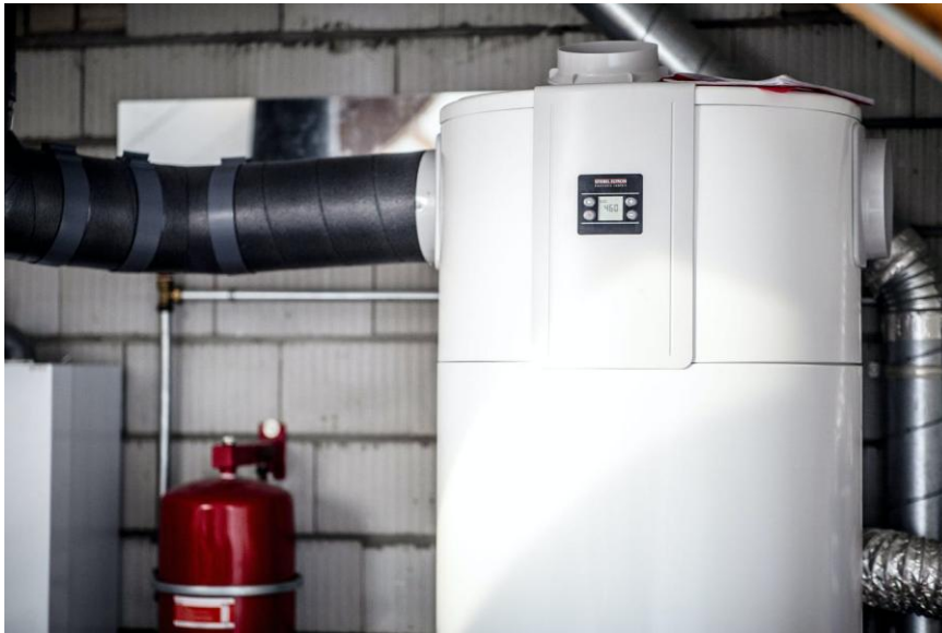
Op zolder bij Meijer staat een warmtepompboiler - niet te verwarren met een warmtepomp - die zorgt voor warm water om te douchen. Het is best een gevaarte, zegt Meijer, maar hij past op zolder. Foto: Marijn Fidder voor het FD
